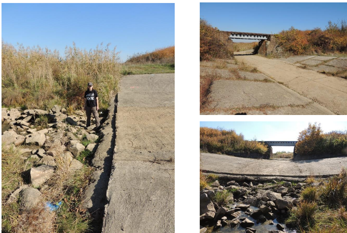
Figura nr. 3-39 Betonarea albiei unui râu în zona unui podet de cale ferată. Râul își continuă curgerea pe sub plăcile de beton, însă continuitatea ecologică pentru fauna acvatică este întreruptă
