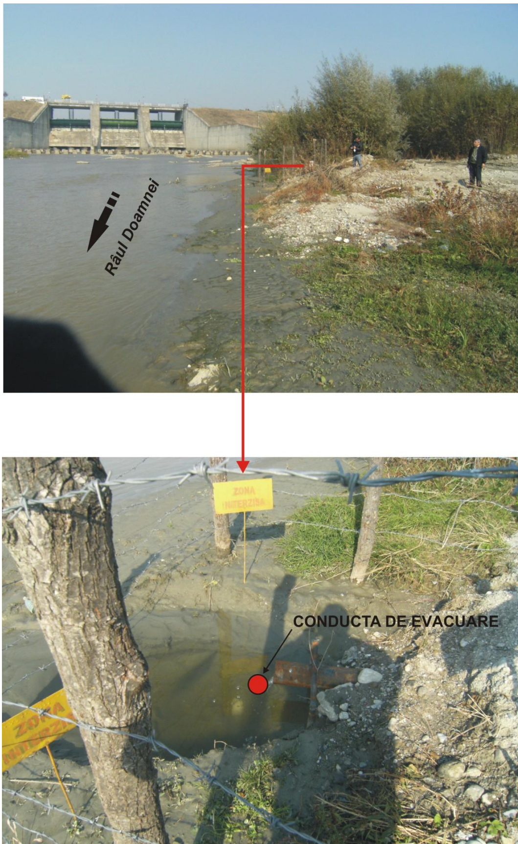
Fig.11. Locația conductei de evacuare a apei tehnologice în Râul Doamnei
